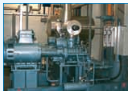
GEA Grasso Duo Pack schroefcompressor met een gezamenlijk koelvermogen van 802 kW
