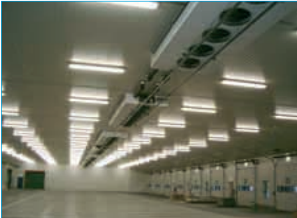
De 'ontvangstruimte'. Boven de centrale rij koelers; links de geïsoleerde dockings t.b.v. het vrachtverkeer.
